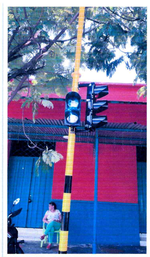
INSTALACION VEHICULAR SEMAFORO S3
