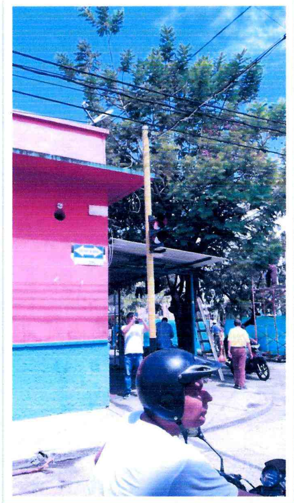
INSTALACION VEHICULAR SEMAFORO S1
