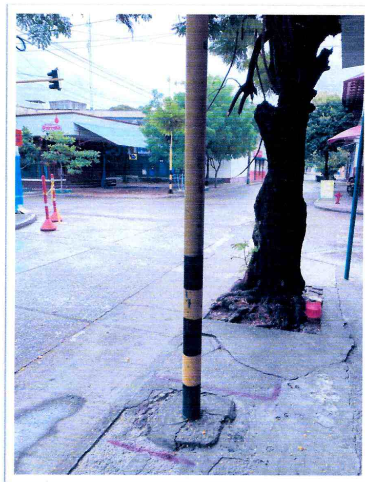
POSTE T1 EXISTENTE
