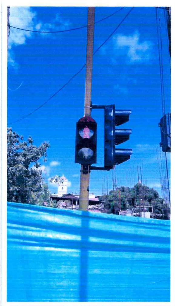
INSTALACION VEHICULAR SEMAFORO S1 Y S3
