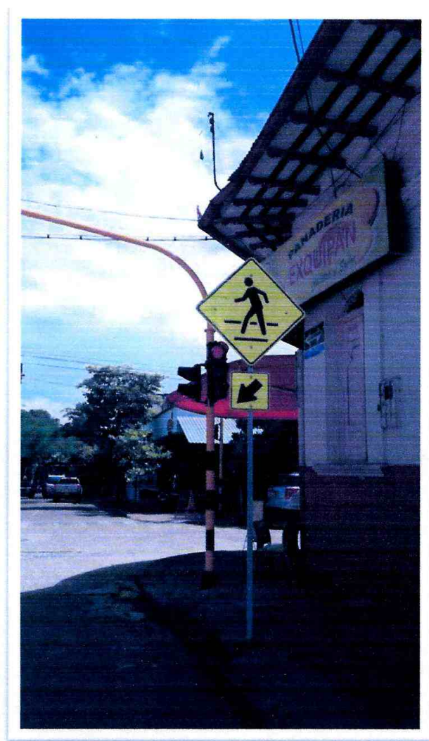
INSTALACION VEHICULAR SEMAFORO S1 Y S3
