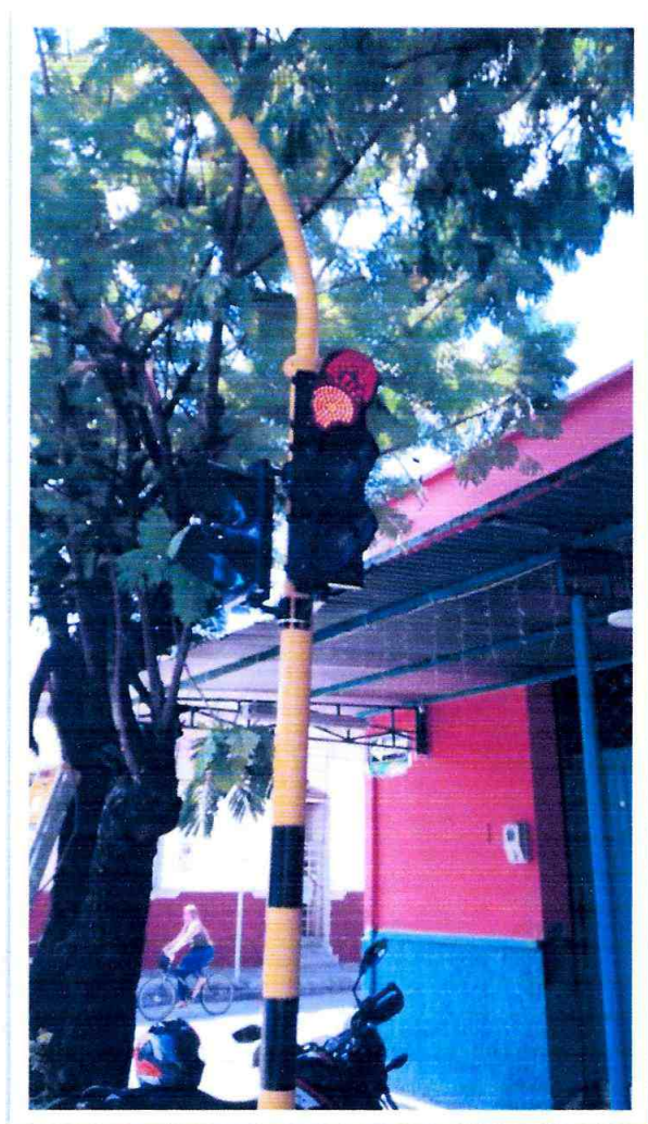
INSTALACION VEHICULAR SEMAFORO S1
